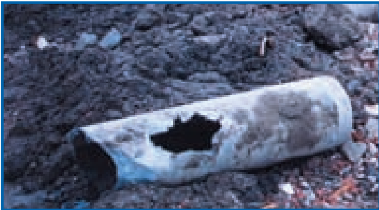
Resim 6.1.3 - 17 Ağustos Marmara Depreminde hasar görmüş PVC ve beton boruların görüntüsü.
