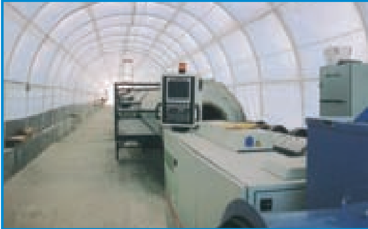
Resim 2.1.12 - Mobil üretim tesisi
